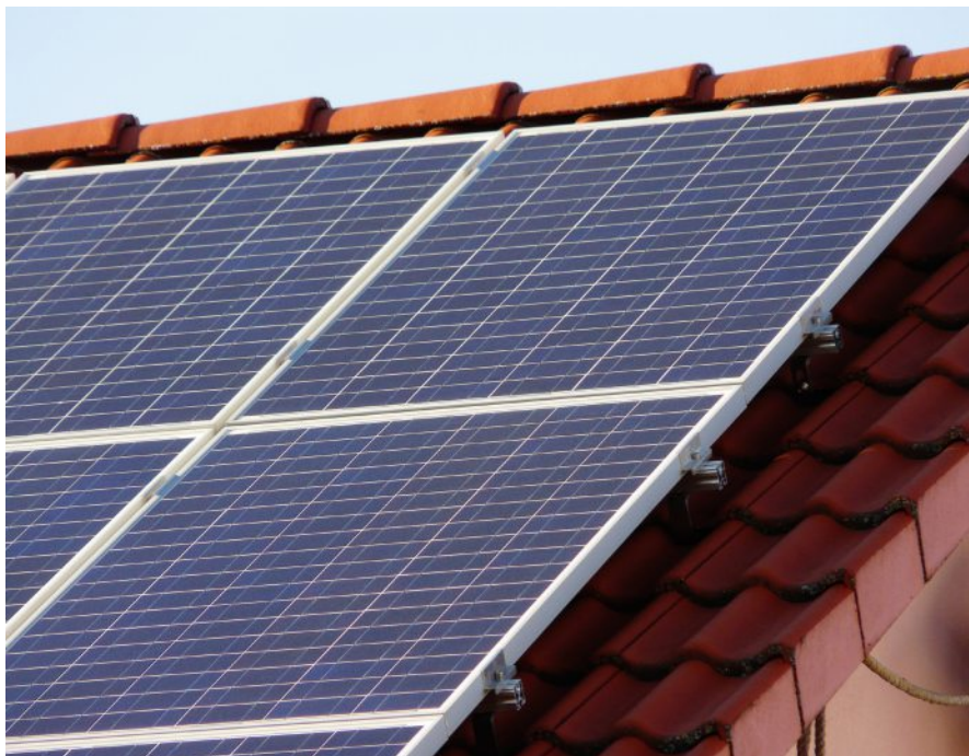
Photovoltaik-Anlagen sind längst ein gewohnter Anblick auf Dächern in Stadt und Land. Foto: LEA
