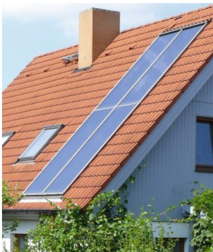
In die Dachfläche integrierter Flachkollektor.
