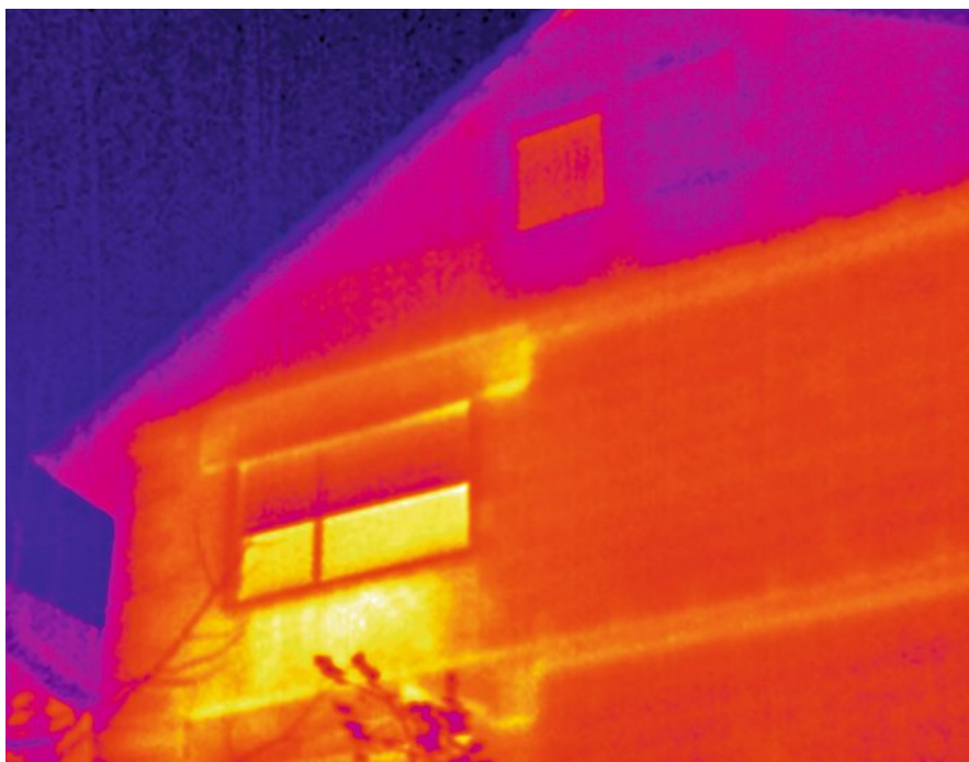
Die Außenthermografie zeigt energetische Schwachpunkte an der Fassade auf.
