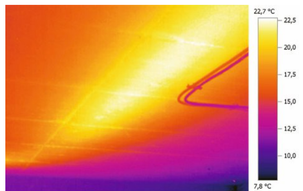
Thermografie macht den Wärmeabfluss durch die Kellerdecke in hellen Farben sichtbar. Fotos: LEA
