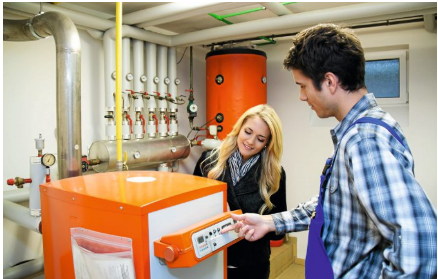
Die Wahl der Heizung hängt auch vom Dämmstandard des Hauses ab.
