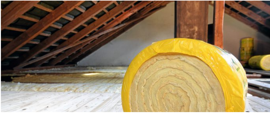
Dachdämmung will durchdacht sein. So ist etwa das Thema Luftfeuchtigkeit zu beachten. Foto: LEA
